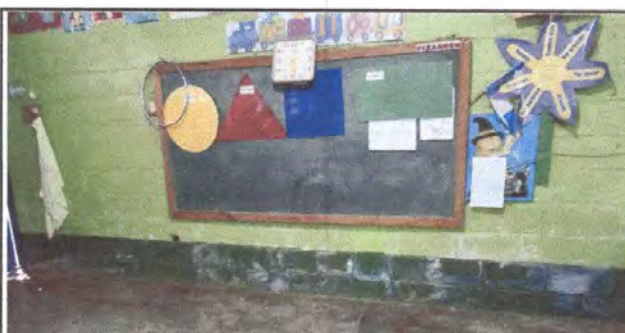
Foto 12: Repello en paredes.
