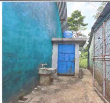
Foto 10: Sustitución de tonel por cisterna para almacenaje de agua para baños.
